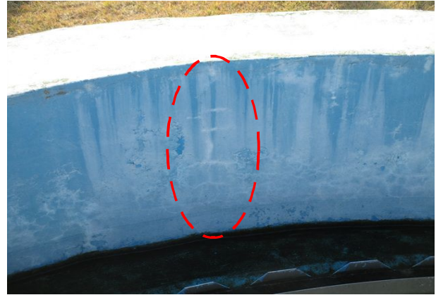
내부 벽체 균열 및 백태 (L=0.5m)
