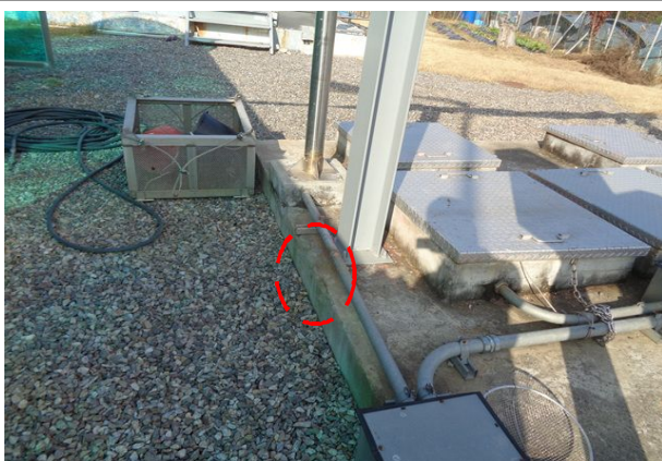
외부 바닥, 콘크리트 파손 (A=0.2m×0.2m, 2EA)
