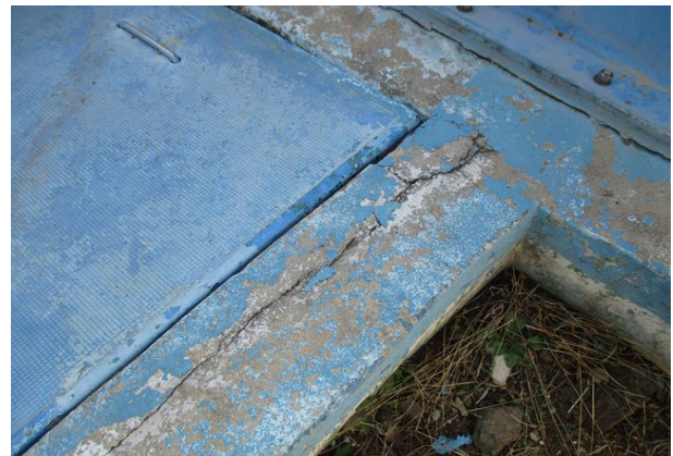
외부 바닥 콘크리트 박락 (A=0.1m×0.5m)
