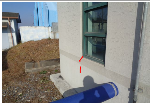
외부 벽체 균열 (CW=0.2mm, L=0.5m)
