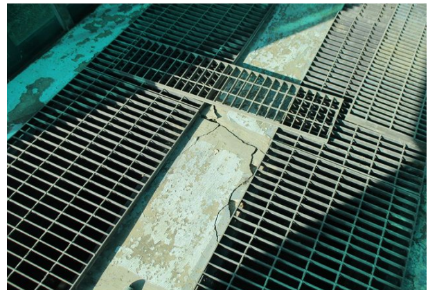
바닥 콘크리트 박리 및 박락 (A=2.5m×0.3m)
