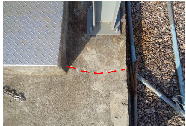
외부 바닥, 균열 (CW=0.1mm, L=0.5m)
