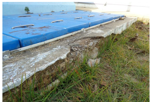
1층 내부 (연결동) 바닥 콘크리트 박리 및 박락 (A=4.0m×0.5m)
