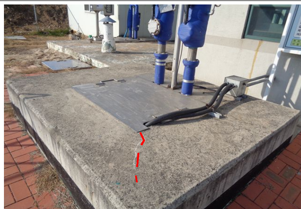
외부 바닥 균열 (CW=0.2mm, L=0.5m)
