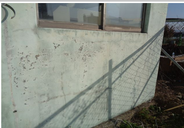
외부 벽체 망상균열 (A=2.0m×1.0m)
