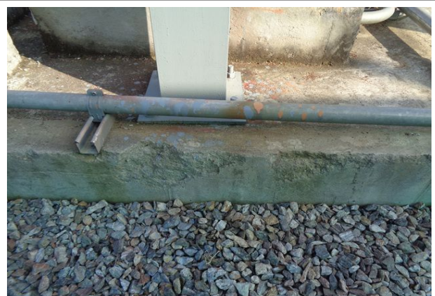
외부 바닥, 콘크리트 파손 (A=0.2m×0.2m, 2EA)
