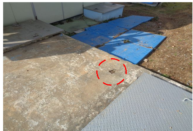
외부 바닥 콘크리트 박리 (A=0.1m×0.1m)
