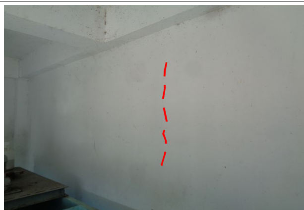
내부 벽체 균열 (CW=0.1mm, L=1.5m)
