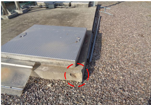
외부 바닥, 콘크리트 파손 (A=0.3m×0.2m)
