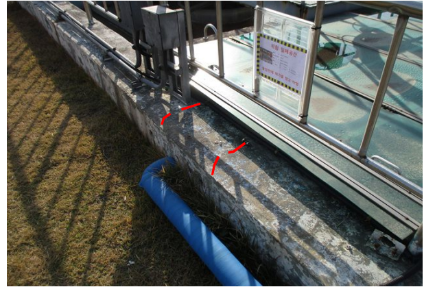
외부 바닥 균열 (CW=0.2mm, L=0.5m, 3EA)
