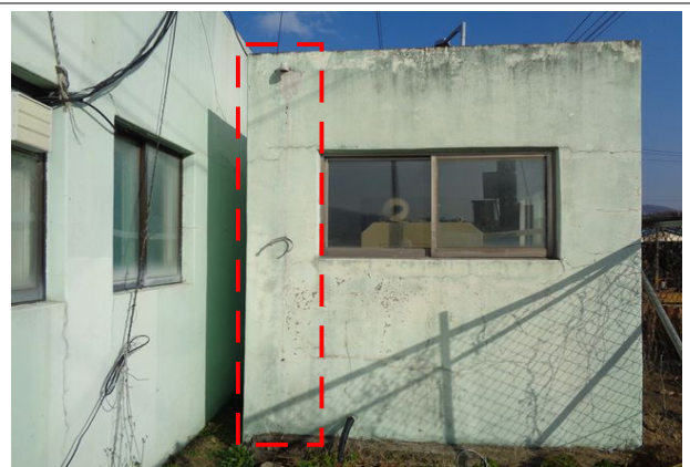
외부 배수시설 배수관 탈락 (1EA)
