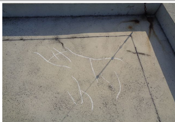
옥상층 바닥 망상균열 (A=2.5m×2.0m)
