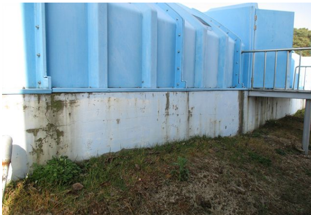
외부 벽체 망상균열/도장박리 (A=15.0m×1.0m)
