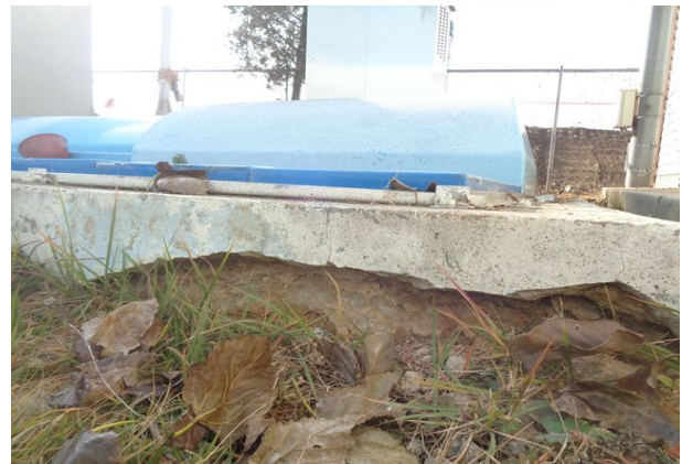
외부 바닥 콘크리트 박리 및 박락 (A=2.5m×0.5m)
