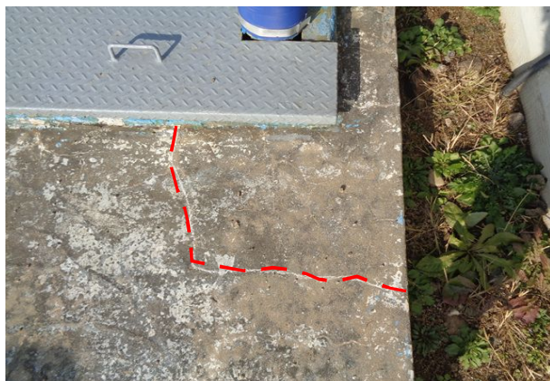
외부 바닥 균열 (CW=0.2mm, L=1.0m)
