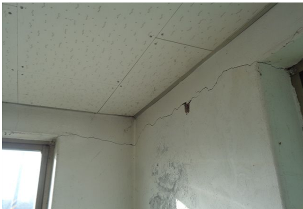
내부 벽체 균열 (CW=0.3mm, L=1.0m)
