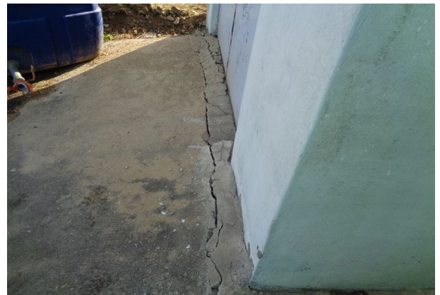
외부 출입구 콘크리트 박락 (A=3.5m×0.2m)
